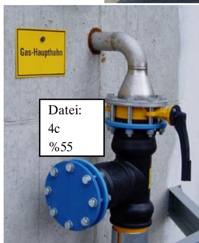
Der Gas-Haupthahn muss deutlich als solcher zu erkennen sein. Außerdem müssen Pfeile die Auf- und Zu-Stellung des Hebels kennzeichnen.
