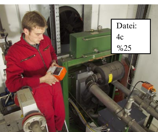
Ein Gas-Messgerät gehört zur Standardausrüstung jeder Biogasanlage.
